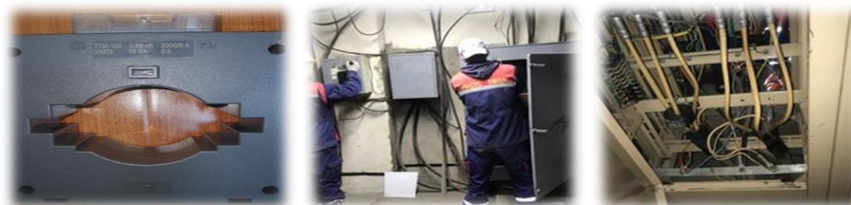
Зураг 13. Гүйдлийн трансформаторыг сольж шинэчилсэн байдал
