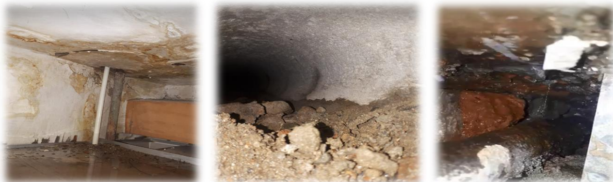
Зураг 16. Ариун цэврийн өрөөний цэвэр бохир, халуун хүйтэн, өгөх буцахын халаалтын шугам ханан дундаа цоорсныг P20-ийн цагаан шугамаар сольж шинэчилсэн
