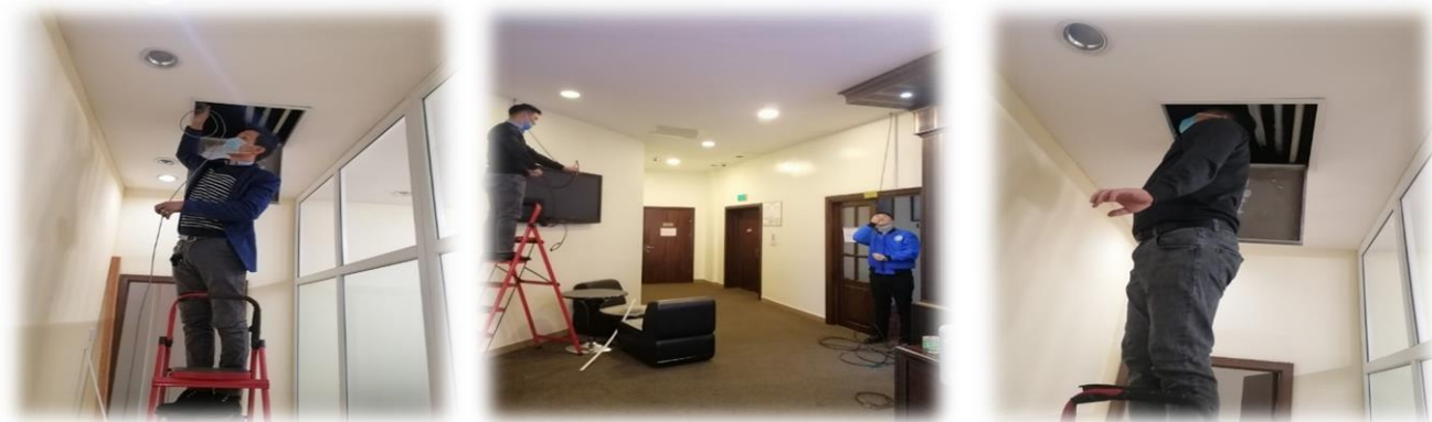
Зураг 22. Хурлын заалны WGA кабелийг HDMI кабелиар сольсон байдал
