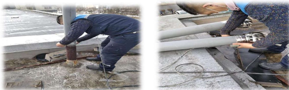
Зураг 18. НЗЗ-ны 5-р байрны 5Б корпусын ариун цэврийн өрөөнд диффлектор 2ш, өрөөний агааржуулалтын сэнс 2 ширхгийг суурилуулсан
