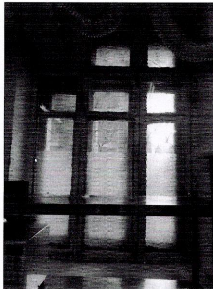
Зураг 2. Хоол үйлдвэрлэлийн өрөөний үзэмж муудсан цонх
