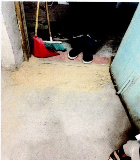
Зураг 9. Цахилгааны щитны өрөөнд ус орохоос сэргийлж элс асгасан байдал
