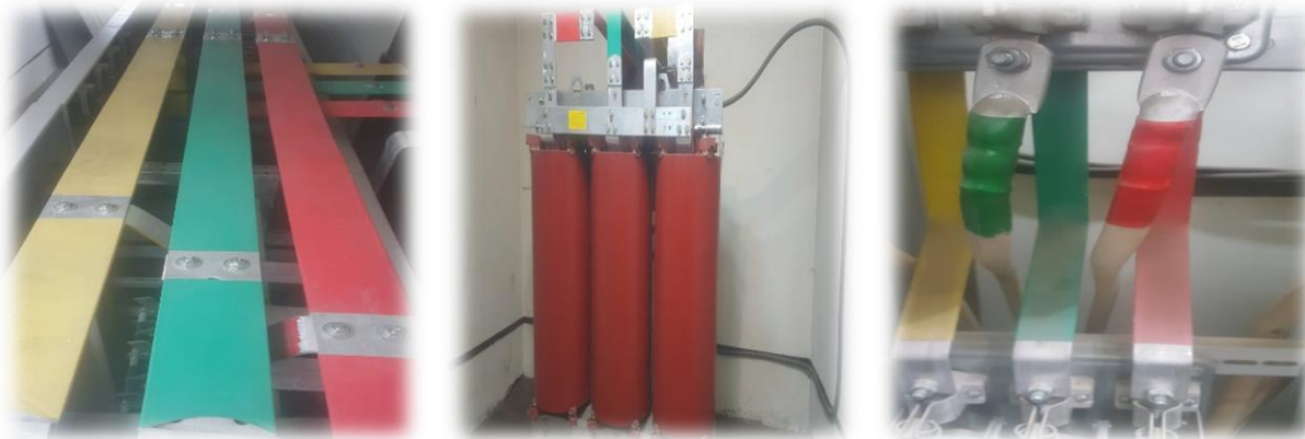
Зураг 38. НЗЗ-ны 2-р байр буюу Хангарди ордны ачаалал даахгүй автомат салгуурыг шинэчилсэн байгаа байдал
