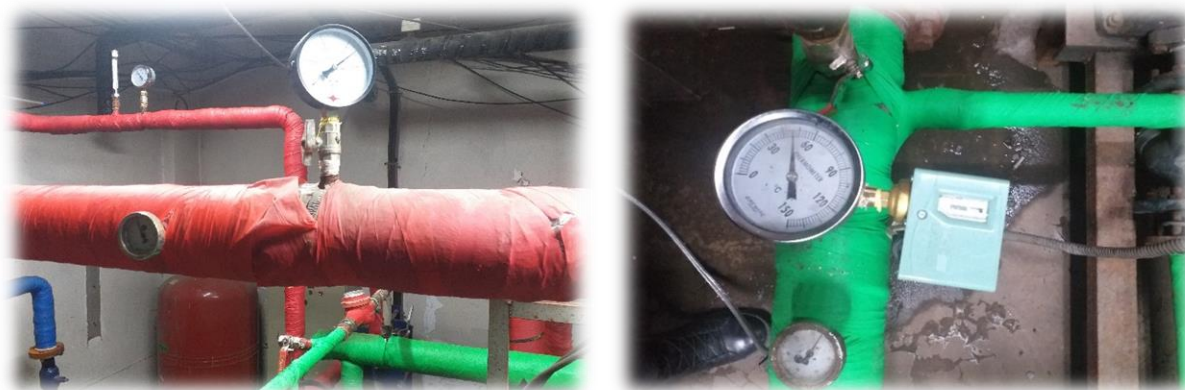
Зураг 46. Хэмжигч суурилуулсан байдал
